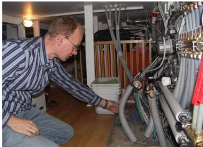
Et velordnet, overskueligt teknikrum med isolerede rør. Der er skiltning på alle rør, haner og knapper. Det er vigtigt at både far og mor kan overskue teknikken. Fremtidige servicebesøg bliver både billigere og bedre, når alle nemt forstår opbygningen af et anlæg.
