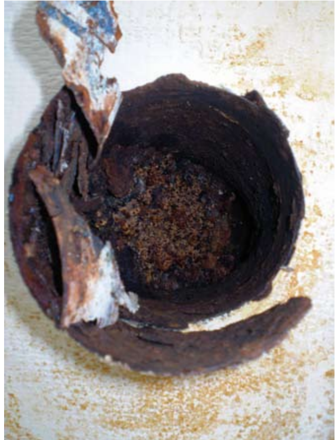
Et kig ind i aftrækket efter aftræksbøjningen var fjernet. Bemærk materialets tilstand.
