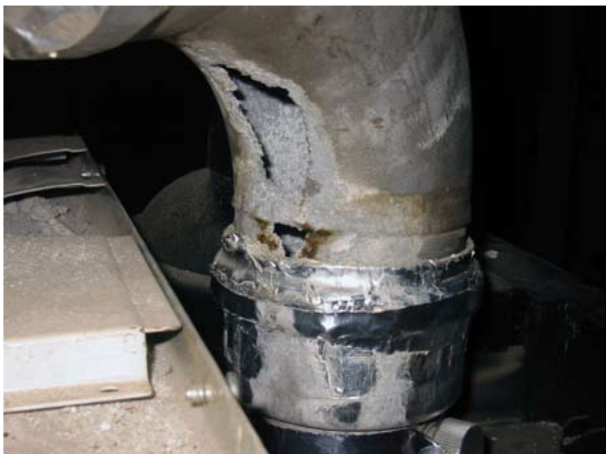
Eksempel på et aluminium røggasrør fra en lukket kedel med splitaftræk."
