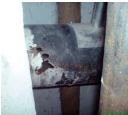
Et eksempel på et røgrør fra en kedel med gasblæseluftbrænder. Billedet er vel at mærke taget efter der blev slået på det.
